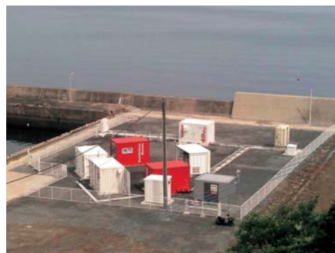
図5 水素設備全景
